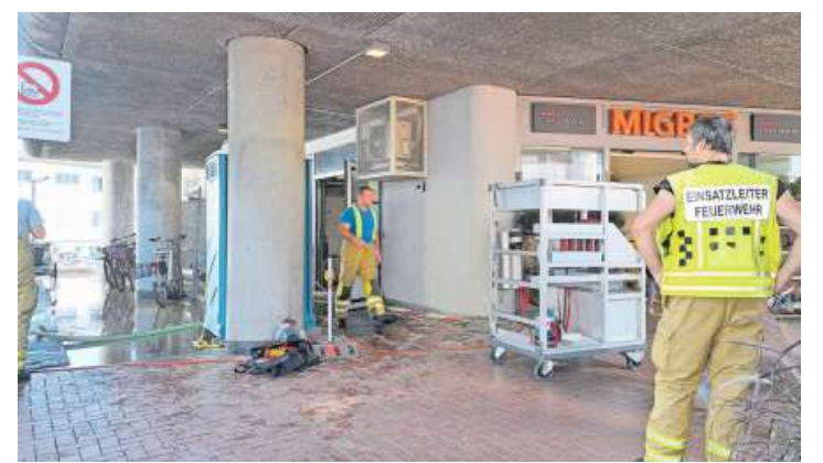
Die Feuerwehr hilft in der Migros beim Wasserabpumpen. Bild: cm
